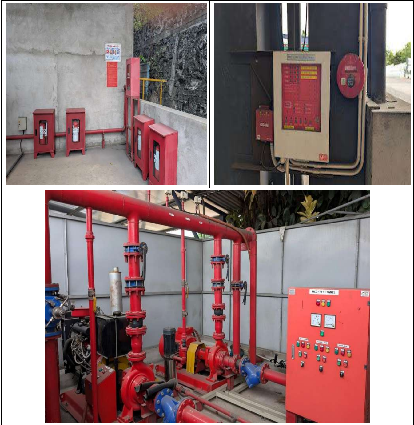
Hình 3. 15. Hình ảnh hệ thống PCCC của dự án
